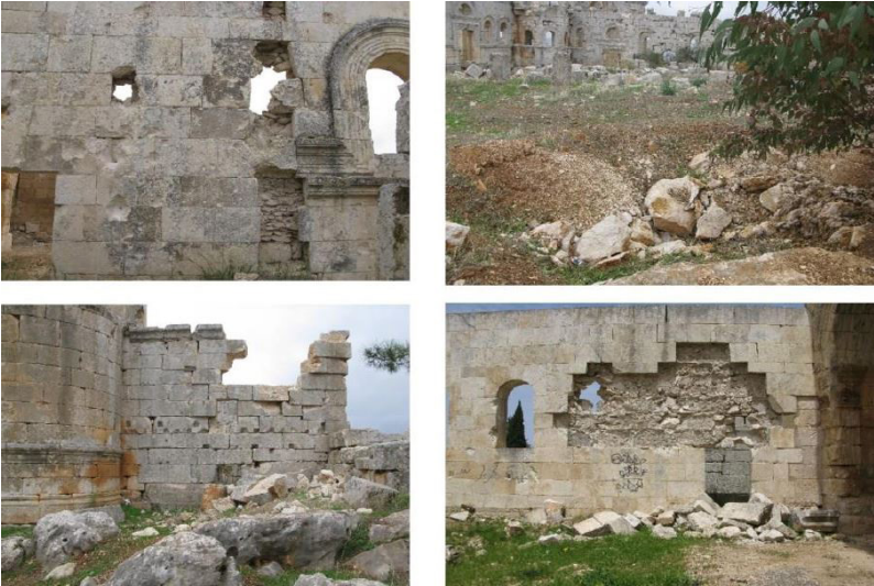
الشكل (21) آثار القصف الجوي على الواجهة الشمالية للبازيليك الشرقي - © سمات - 2020.
