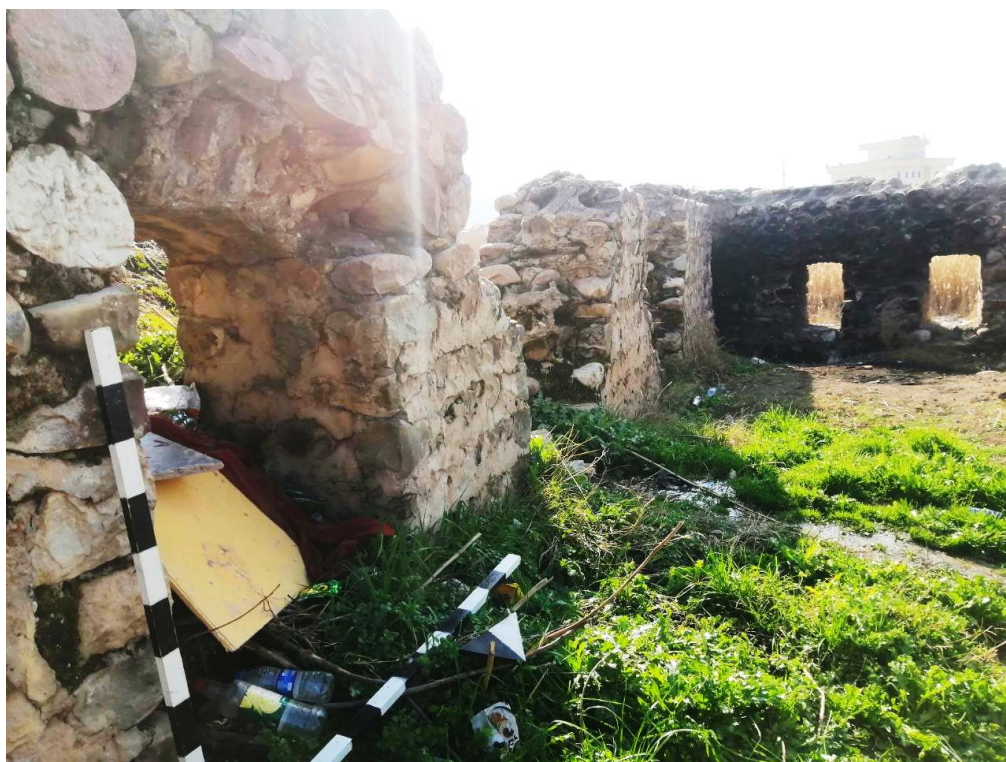
الصورة (٥) النافذة والمدخل والحنيتين في الجدار الجنوبي، والنافذتين في الجدار الغربي/ تصوير الباحثة
