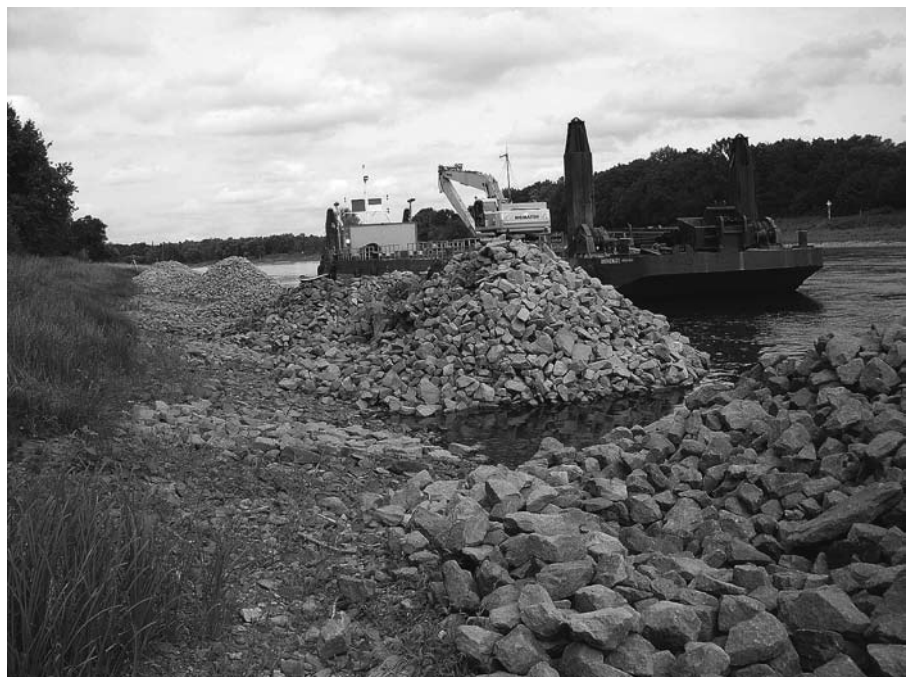
Abb. 1: Derartige Baumaßnahmen laufen seit Jahren an vielen Abschnitten der Elbe ohne UVP und ohne Öffentlichkeitsbeteiligung – hier im UNESCO-Welterbegebiet Dessau-Wörlitz – allein auf der Grundlage von Baugenehmigungen aus den 30-er Jahren des letzten Jahrhunderts. Foto: E. P. Dörfler
