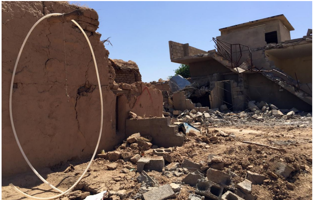
خانوی ویرانکراو له قهرتهپه که هیشتا هنیامی (X) سوری ی پیوه دیاره، ۲۰ ی نیاری ۲۰۱۶. © ۲۰۱۶ هیومان رایتنس فوج
